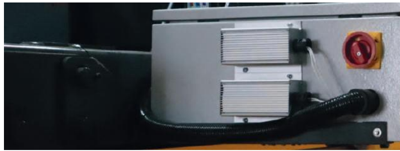
Kablo Spiral ve Kanalı
